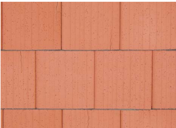
Bild 12: Ziegelmauerwerk mit Trocknungs- oder Brennrissen
