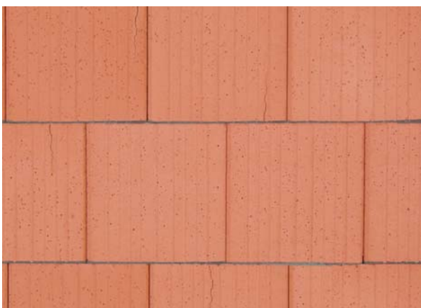
Bild 12: Ziegelmauerwerk mit Trocknungs- oder Brennrissen
